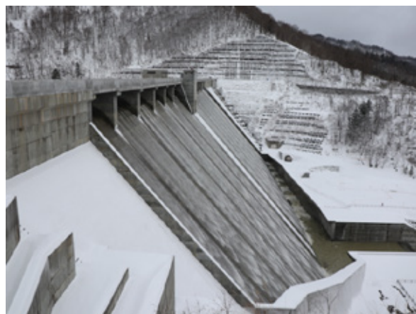
写真-14 サーチャージ水位到達時の状況②
