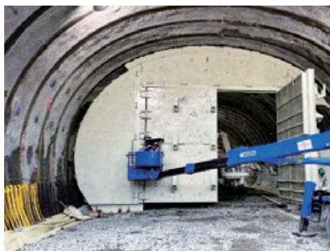
防音扉設置状況
