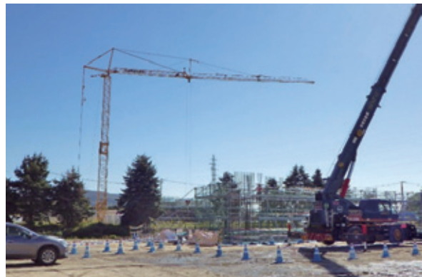
写真-1 定置式ジブクレーン
