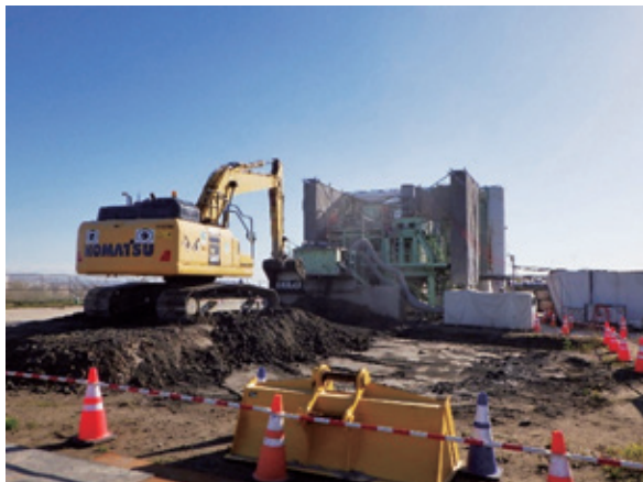
写真-6 回転式破碎混合プラント
