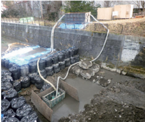
ポンプ運転状況
