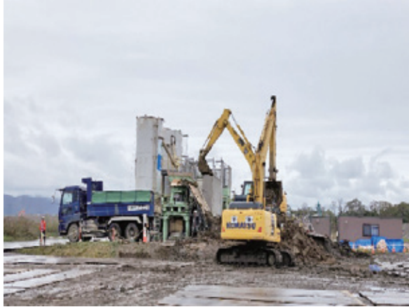
写真－２ 回転式破碎混合プラント
