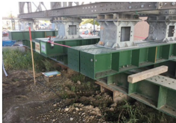
写真－13 センサー設置状況
