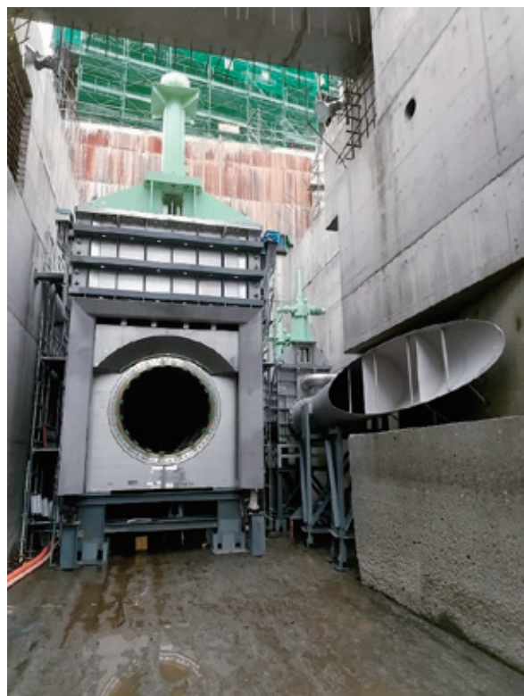
写真－２ 利水放流設備（大放流主ゲート）
