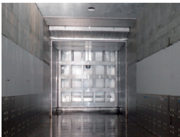
写真-7 融雪期放流設備主ゲート（調節ゲート）
