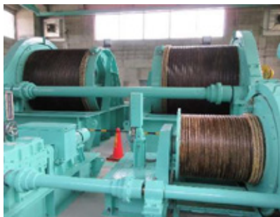
取水ゲート開閉装置
