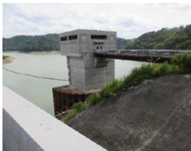
取水ゲート設備
