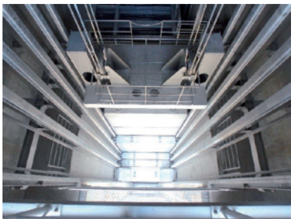
写真-5 選択取水ゲート（取水塔上部より）
