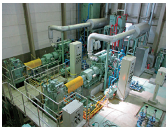
写真① 赤平排水機場（更新前）場内写真
