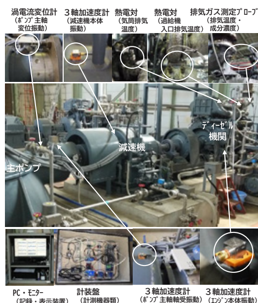
図－6 状態監視モニタリングシステム設置事例
