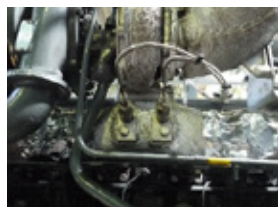
写真-4 過給機入口熱電対
