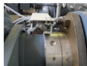
写真-8 ポンプ主軸回転計渦電流変位計
