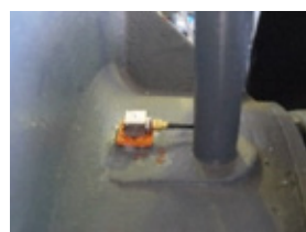
写真-6 減速機上部加速度計
