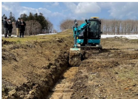
写真5 (オフセットブームでの掘削状況) (前方から見た掘削作業風景)
