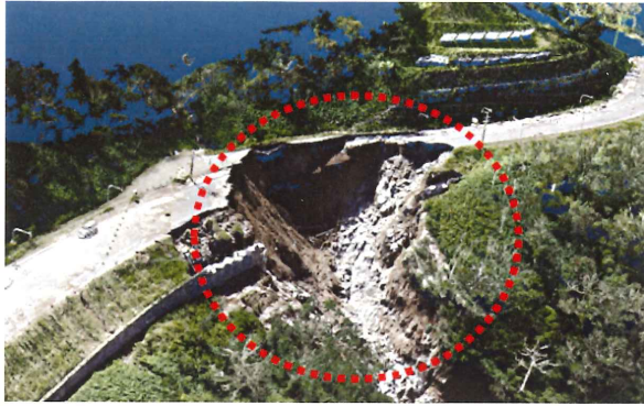
写真-7 日勝峠274号 被災状況
